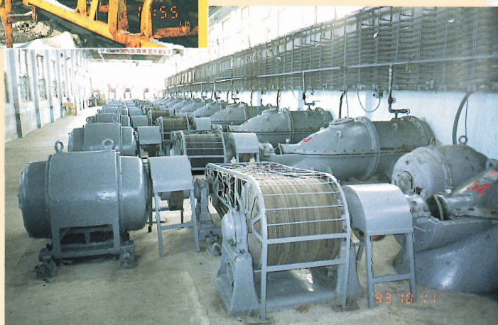
海水取水ポンプ
